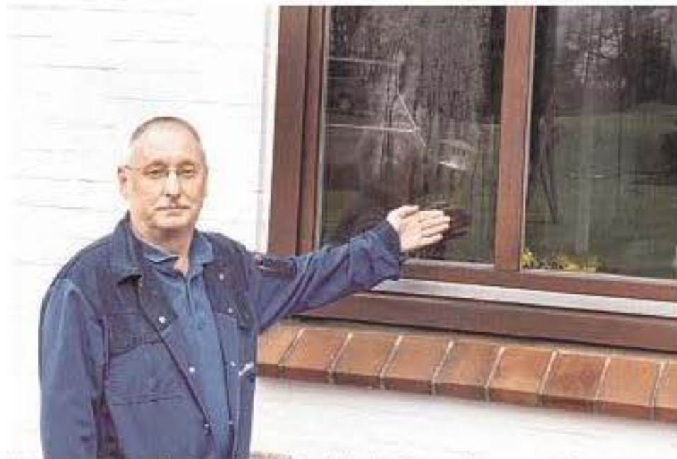
Hausmeister Helmut Kindler hält die Renovierungen für notwendig. Dieses Fenster lässt sich nicht mehr öffnen. KETELS
